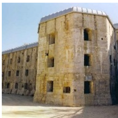
Die ehemalige österreichische Festung "Werk Gschwent" auf der Hochebene von Lavarone, die nach umfangreichen Restaurierungen wieder zugänglich ist.
